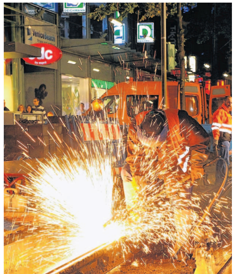
Greller Funkenregen in der Nacht: Die Gleisarbeiten an der Weiche zwischen Marktplatz und Paradeplatz bieten auch ein optisches Spektakel. BILD: TROESTER
